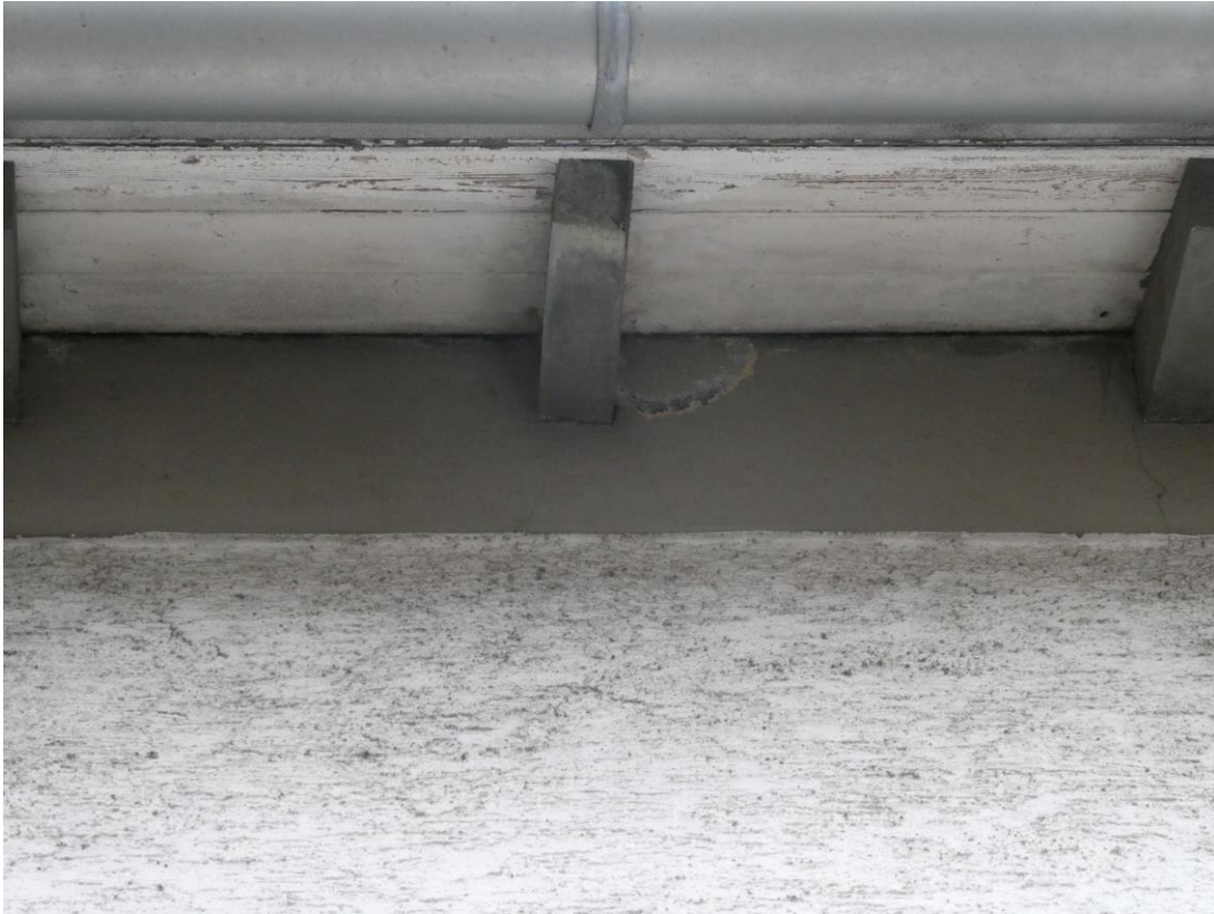
Abb. 5: Dachtraufe, Spuren eines Mehlschwalbennestes
