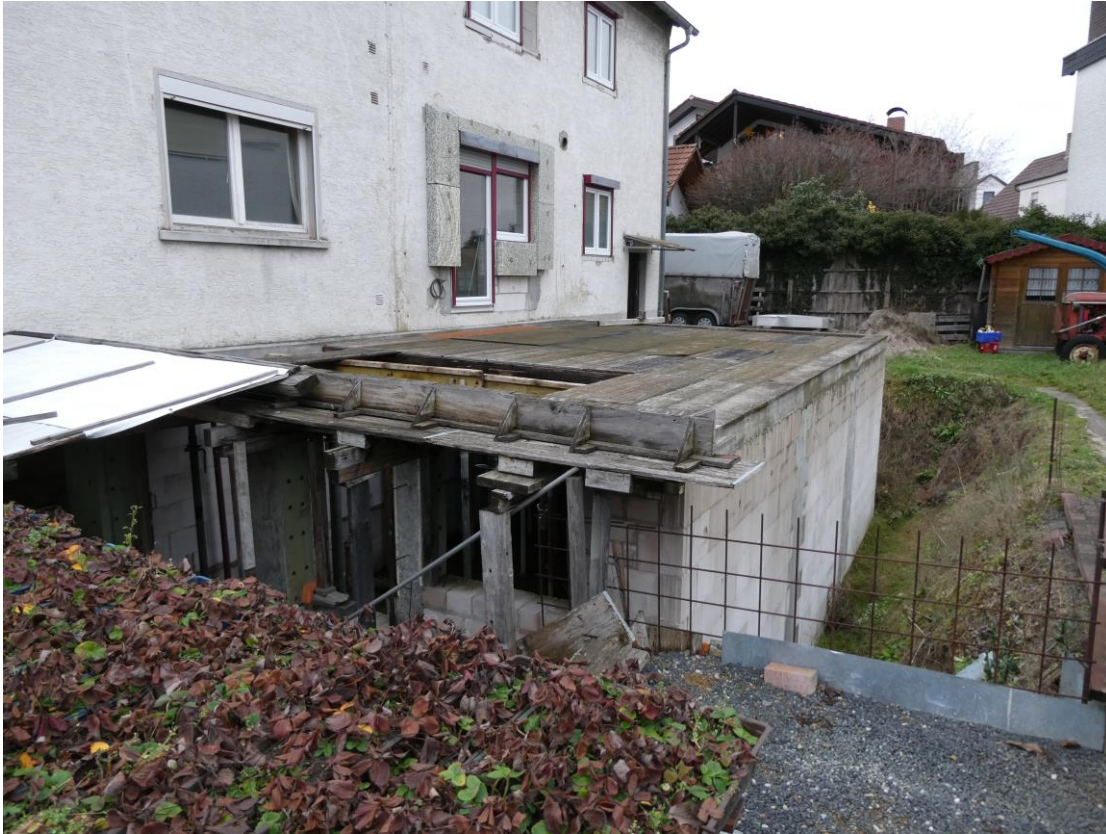
Abb. 7: Unfertiger Anbau auf der Rückseite
