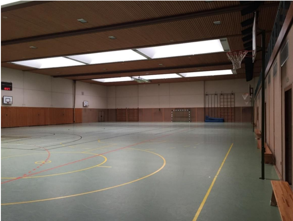
Abbildung 6: Defekter Hallenboden und Dachkonstruktion im Jahr 2014
