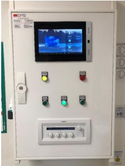
Abbildung 10: Moderne Beleuchtungssteuerung und Lichttechnik (2017)
